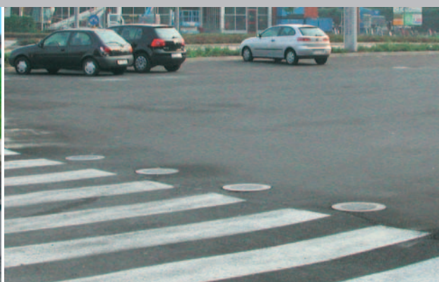
Abbassamento totale a filo pavimento stradale dello Strabuc 918
